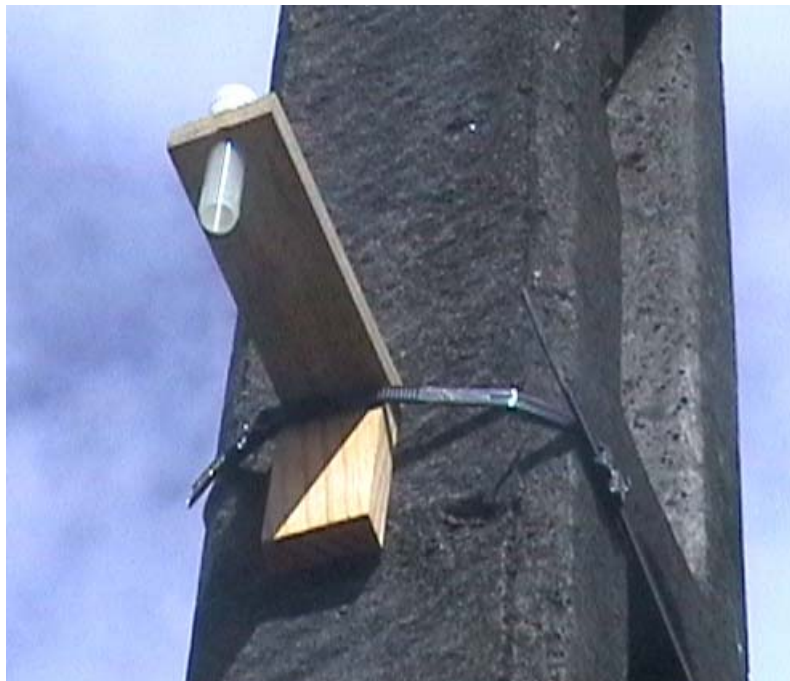
Figure 10 : Tube sur porte-tube accroché à un poteau électrique
