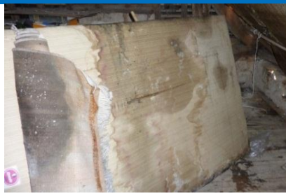
Dégradation d'un matelas
