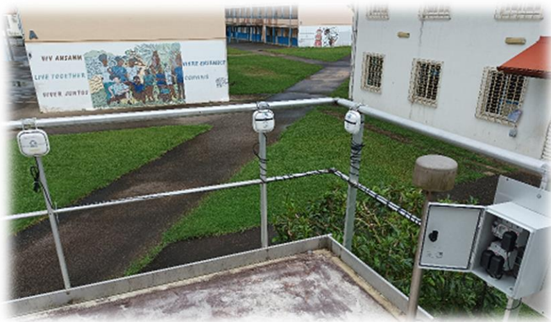
Figure 22 : Mise en place des micro-capteurs sur la station Caeina3
